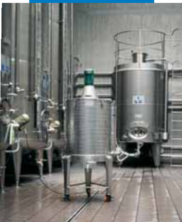
Spoiny w zakładach winiarskich
