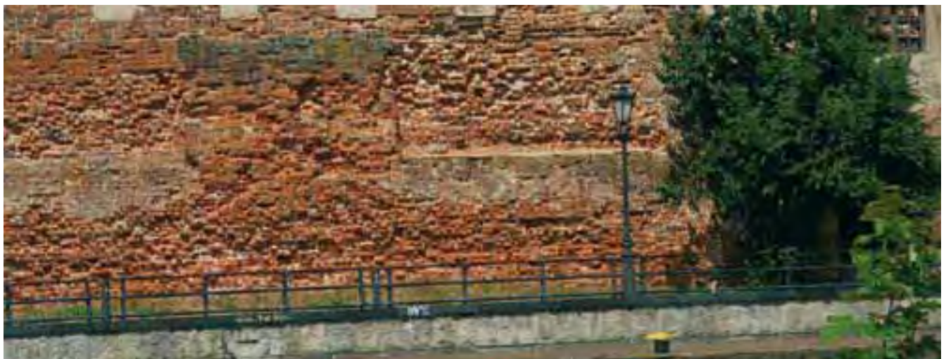
Zniszczona elewacja narażona na długotrwałe działanie wody i wilgoci.
