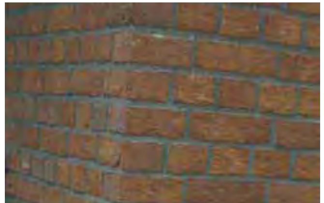
Powierzchnia muru poddana renowacji.
