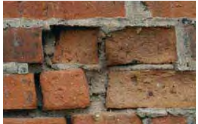
Zaprawy cementowe stosowane przy renowacji powodują niszczenie cegieł.
