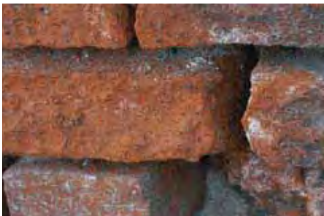
Ubytek zaprawy wapiennej w murze.
