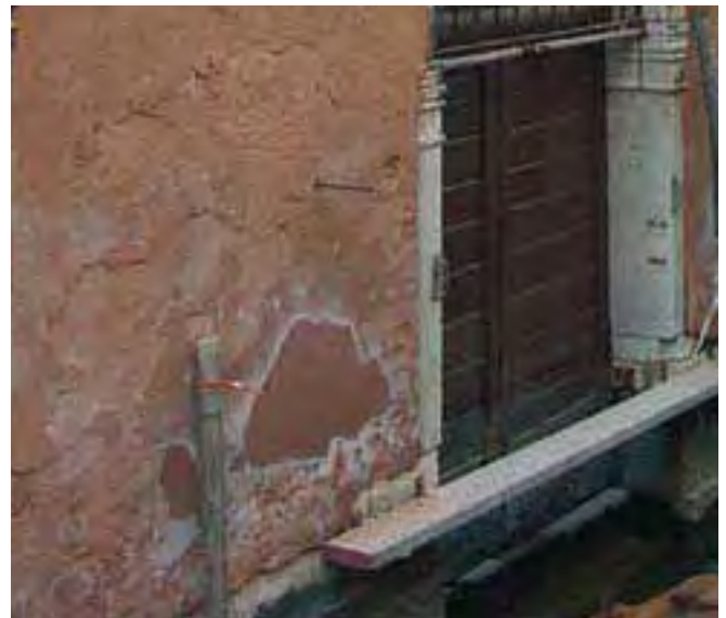
Skutki długotrwałego działania wody.
