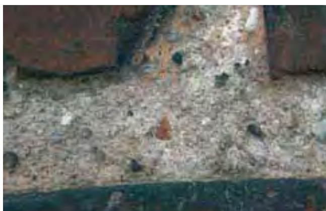
Cegła i zaprawa przed czyszczeniem i renowacją.
