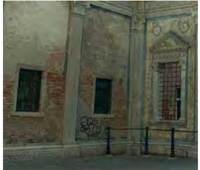
Brak izolacji poziomej.
