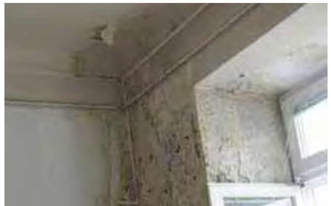
Wilgoć powoduje rozwój mikroorganizmów, a w konsekwencji odpadanie farb i tynków.
