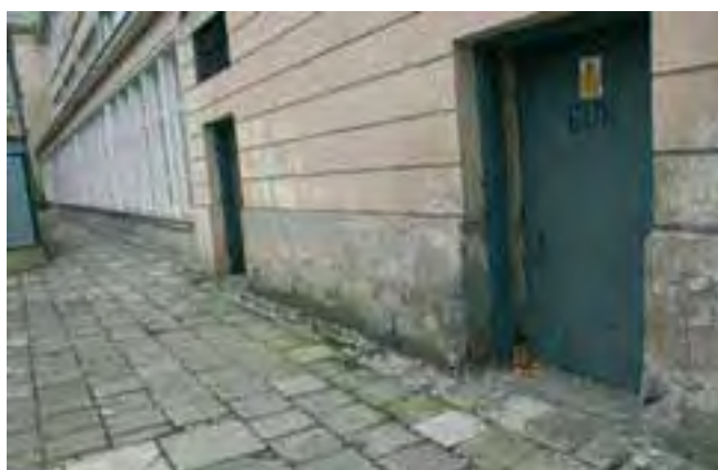
Niewłaściwe ukształtowanie spadków – zalewanie budynków (skutki braku izolacji poziomej muru).
