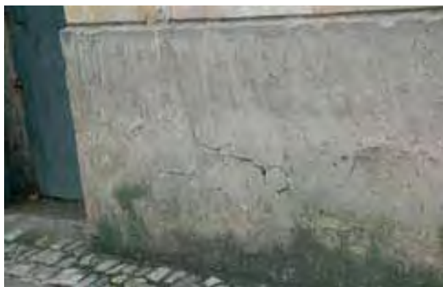
Cokół budynku przed renowacją.
