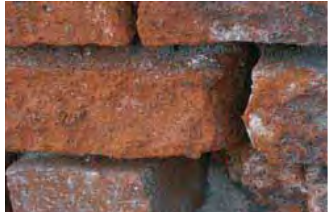
Zniszczona powierzchnia cegły i wypłukana zaprawa.
