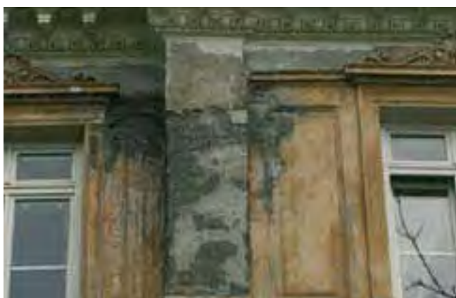
Skutki pękniętej rury spustowej.
