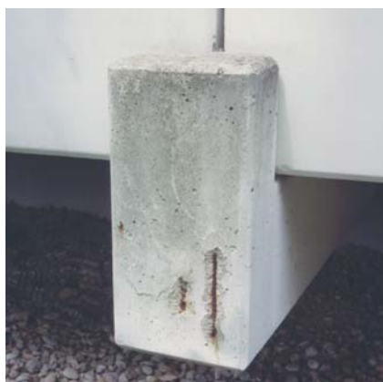
Korozja chlorkowa na wsporniku żelbetowym
