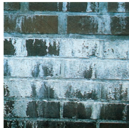
Wykwity wapienne na cegle klinkierowej.
