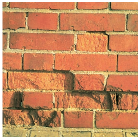
Typowe uszkodzenia cegieł wskutek mrozu (korozja mechaniczna).
