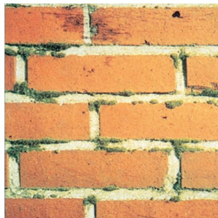
Porosty na murze ceglanym (korozja biologiczna).
