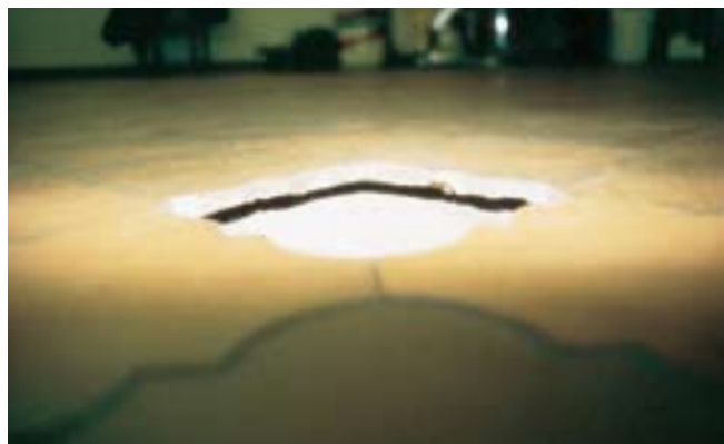
Pustki pod okładziną ceramiczną.
