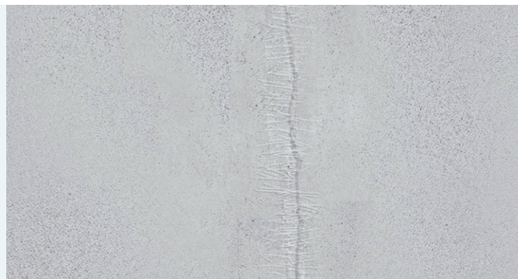
10. Pęknięcie połączone ACRYL-PUTZ® FLEX – transparentna powłoka
